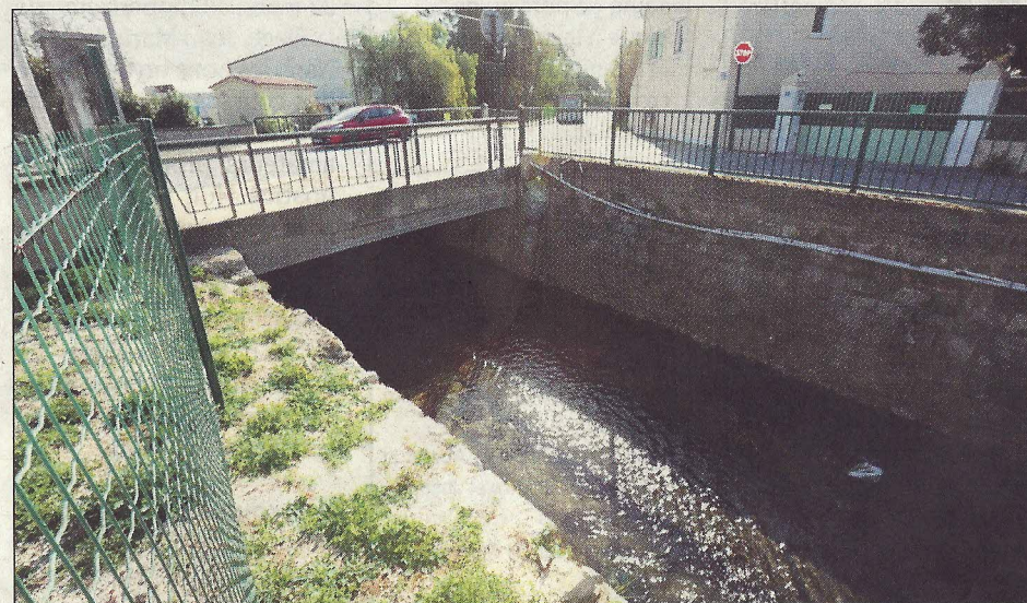
Il est fréquent que le Roubaud sorte de son lit entre le gymnase et le Tennis club. Une solution envisagée est d'assouplir ce changement de direction brutal.
